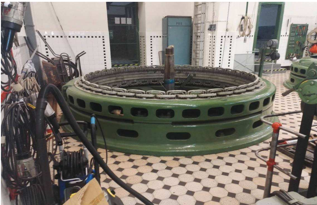
Obr.65 Pohled na hřídel turbíny a stator generátoru při údržbě ve strojovně MVE Hučák
