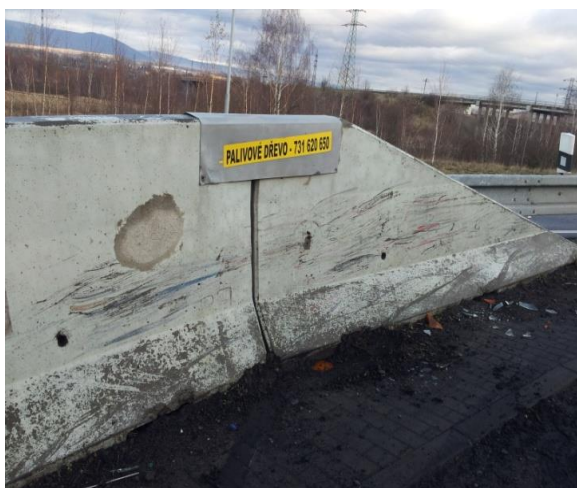
Obrázek 8: Stopy na betonových zábranách od nárazů vozidel
