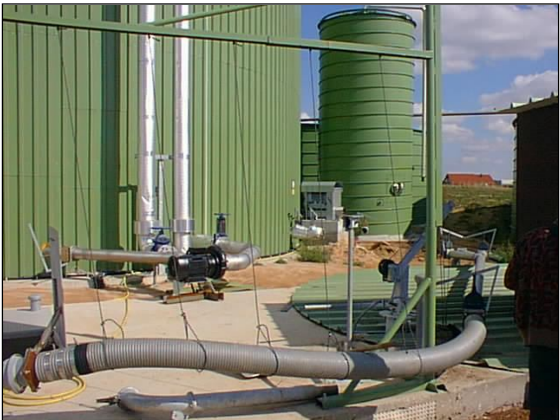
Obrázek č. 6: Čerpání materiálů z bioplynové stanice pomocí čerpadel, zdroj: http://biom.cz/cz/odborne-clanky/bioplyn-v-nemecku (2003)
