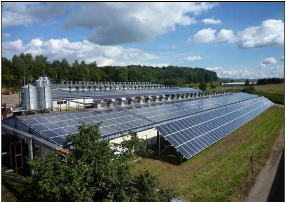
Obrázek č. 26: Velká solární elektrárna v obci Brniště, zdroj: http://www.solartime.cz/Reference.aspx (2012)
