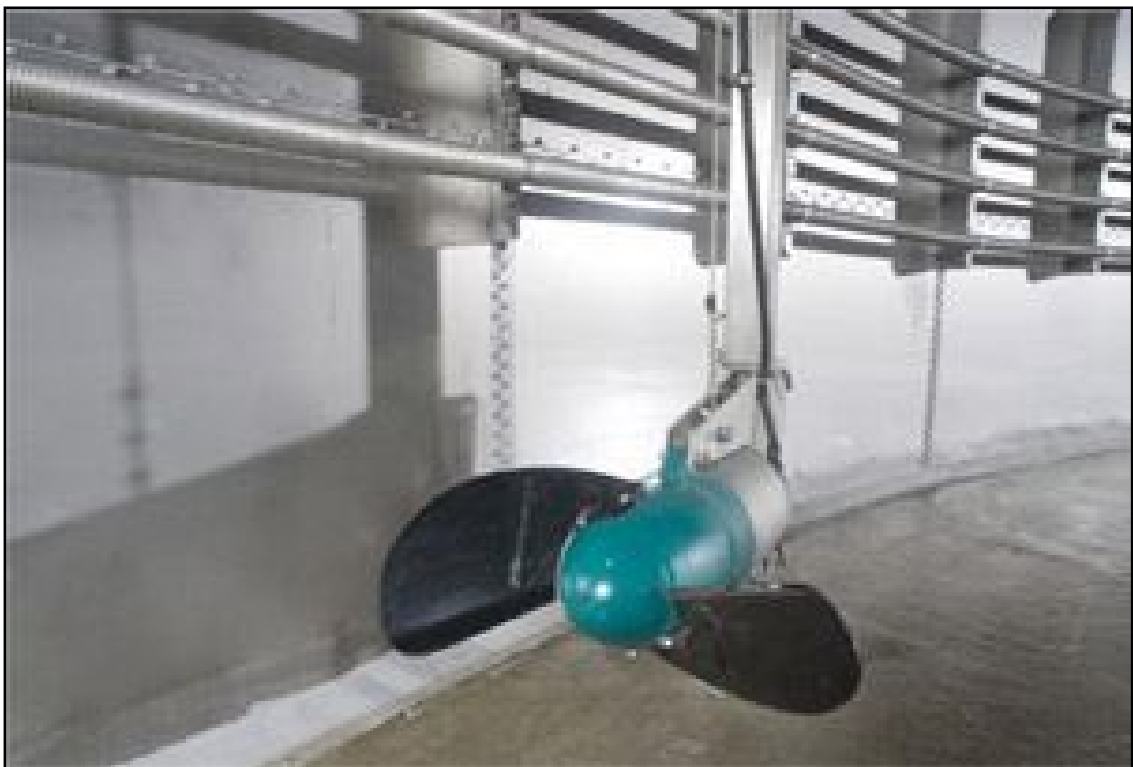
Obrázek č. 4: Ponorné míchadlo bioplynové stanice, zdroj: http://www.weltec-biopower.cz/bioplynové-stanice/technika/michaci-technika (2012)
