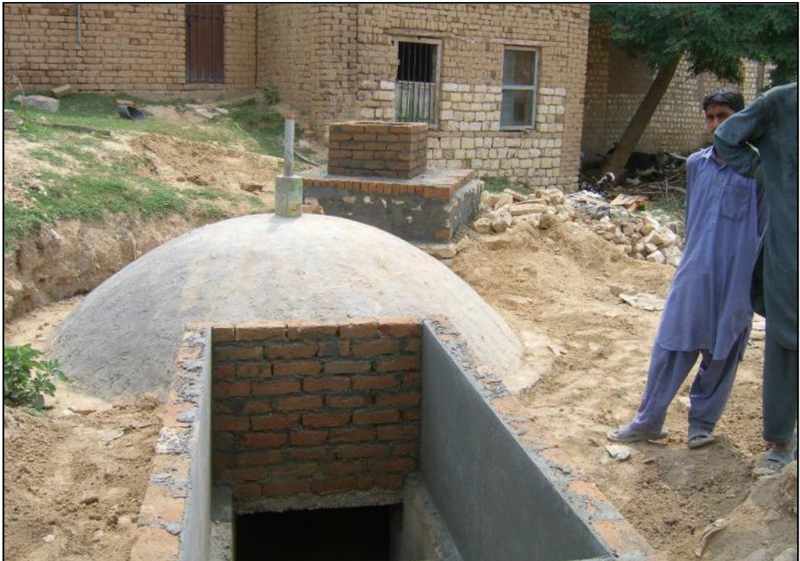
Obrázek č. 13: Zděná bioplynová stanice v Pákistánu, zdroj: http://bio-gas-plant.blogspot.com/2011/08/biogas-plant-pakistan-photo-gallery.html (2011)
