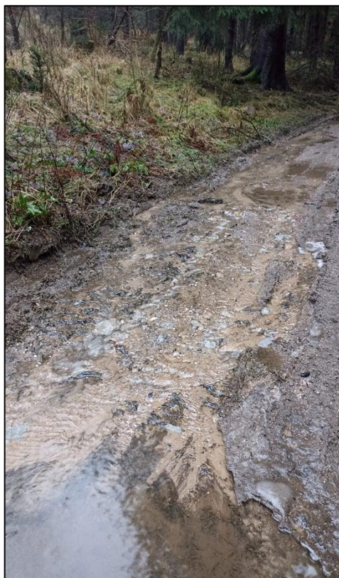
Obrázek 68: Dešťová voda na lesní cestě, fotografie autor
