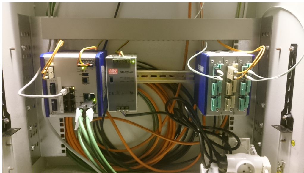
Obr. C.4: Zapojenie rozvádzača hlavného optického rozvodu
