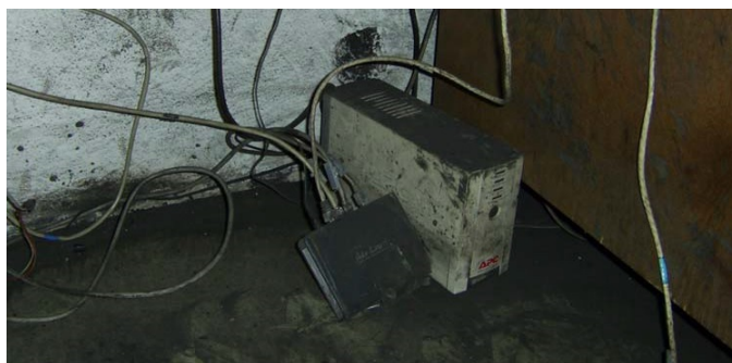
Obr. 5.1: Nevyhovujúci záložný UPS zdroj.
