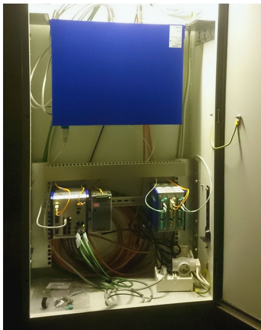
Obr. C.3: Rozvádzač hlavného optického rozvodu
