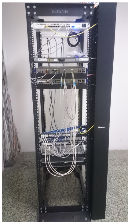
Obr. C.1: Serverovňa - hlavný rozvádzač
