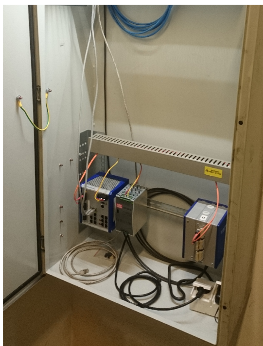
Obr. C.5: Vedľajší rozvádzač T
