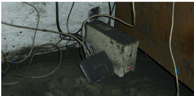
Obr. 5.1: Nevyhovujúci záložný UPS zdroj.
