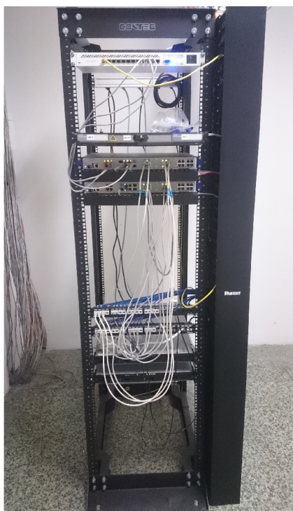
Obr. C.1: Serverovňa - hlavný rozvádzač
