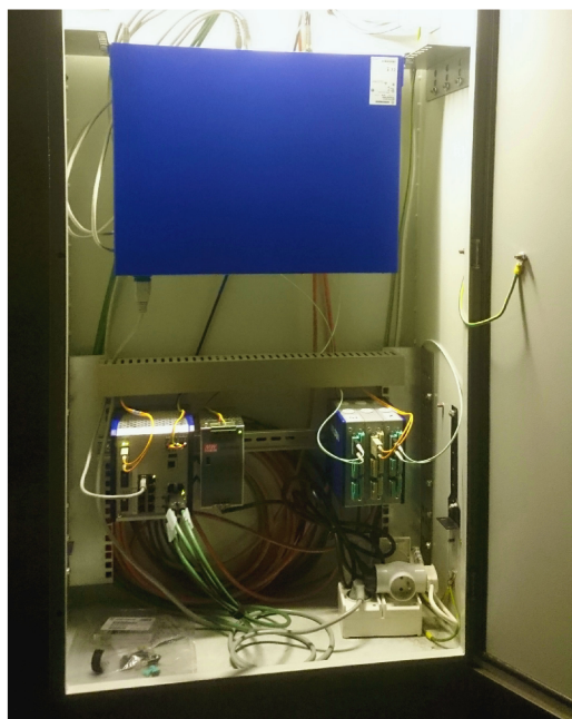
Obr. C.3: Rozvádzač hlavného optického rozvodu
