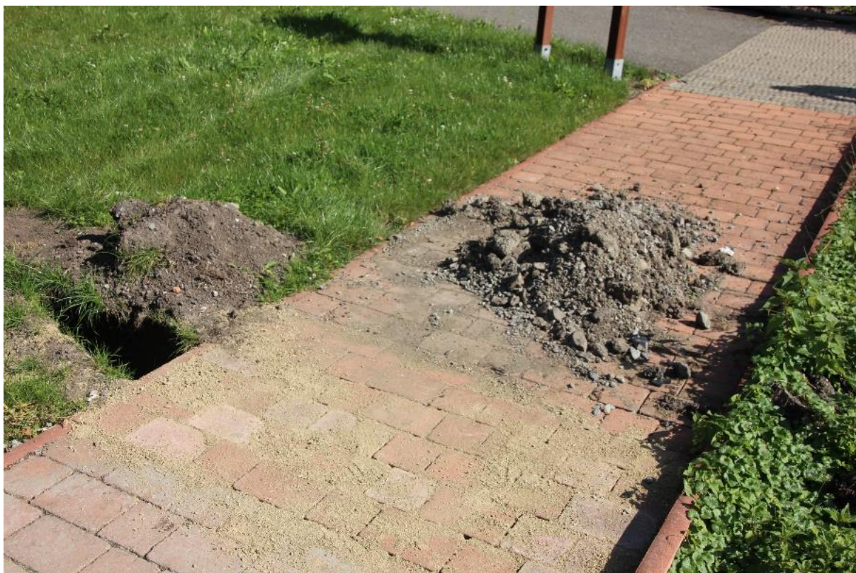
Obrázek 16: Nezabezpečená díra na travnaté ploše a nevhodně umístěná hlína na chodníku
