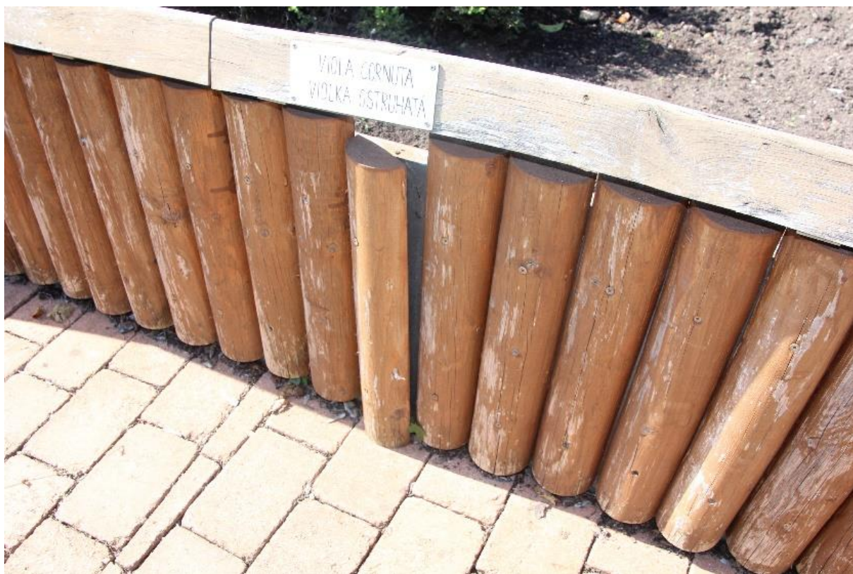
Obrázek 14: Odpadávající půl kulatina z vyvýšeného záhonu
