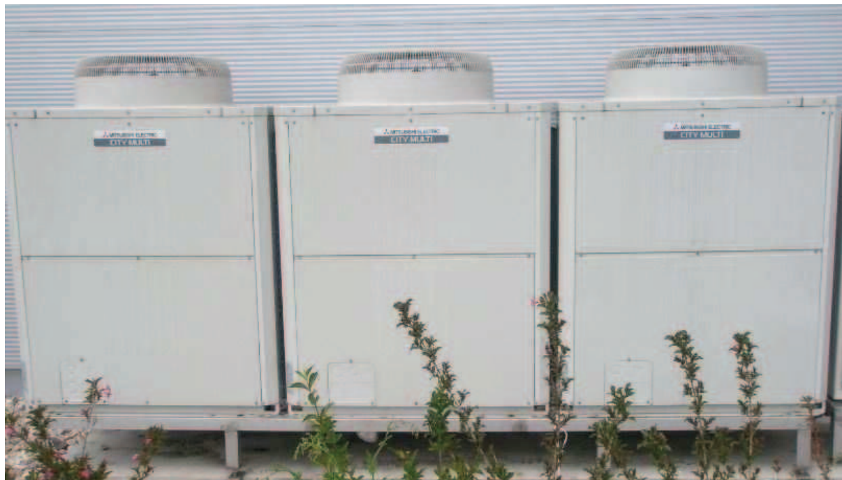
Obr. 35 Venkovní jednotky systému CITY MULTI VRF, zleva: PUHY-EP300-YHM-A (3.NP), PUHY-EP250-YHM-A (2.NP) a PURY-EP250-YHM-A (1.NP, R2 systém)
