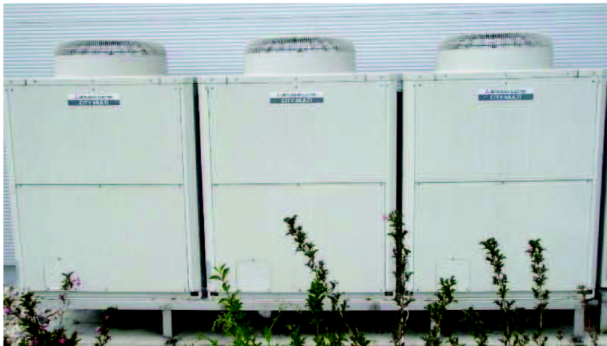
Obr. 35 Venkovní jednotky systému CITY MULTI VRF, zleva: PUHY-EP300-YHM-A (3.NP), PUHY-EP250-YHM-A (2.NP) a PURY-EP250-YHM-A (1.NP, R2 systém)
