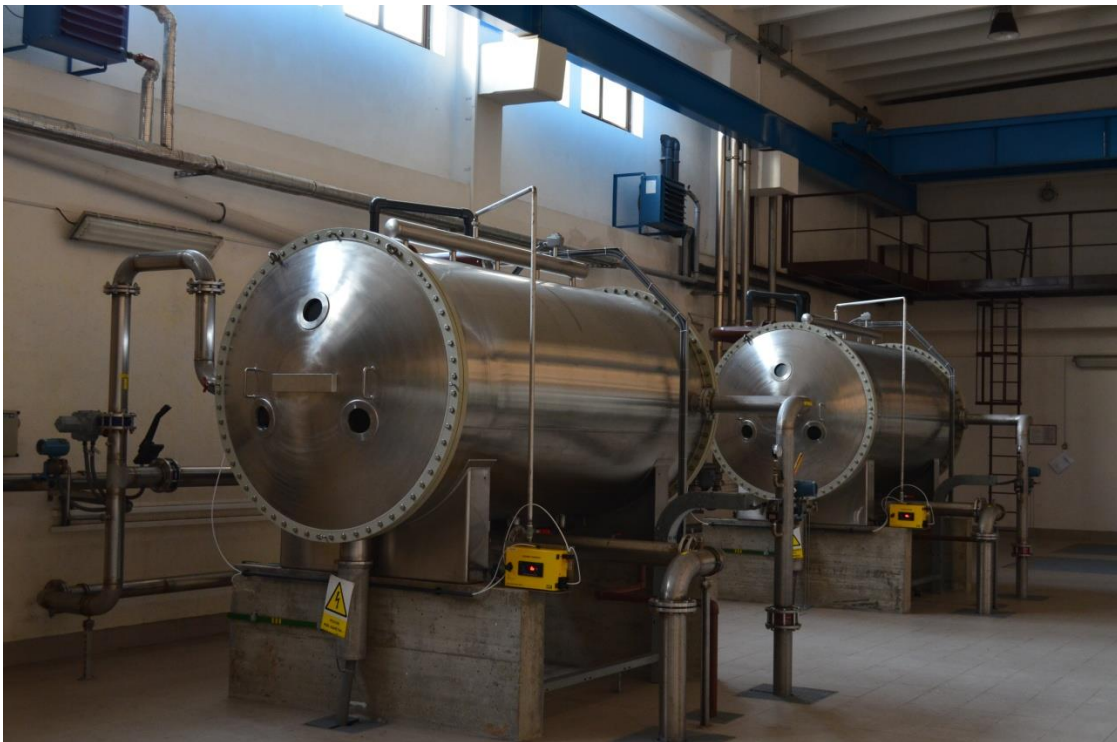
Obrázek 4: Generátory ozónu v budově ozonizace ÚV Švařec
