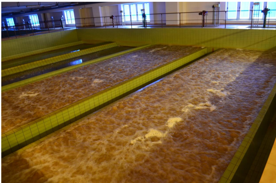
Obrázek 5: Pískový filtr na počátku praní (vpravo) a filtr v průběhu filtrace (vlevo) v ÚV Švařec
