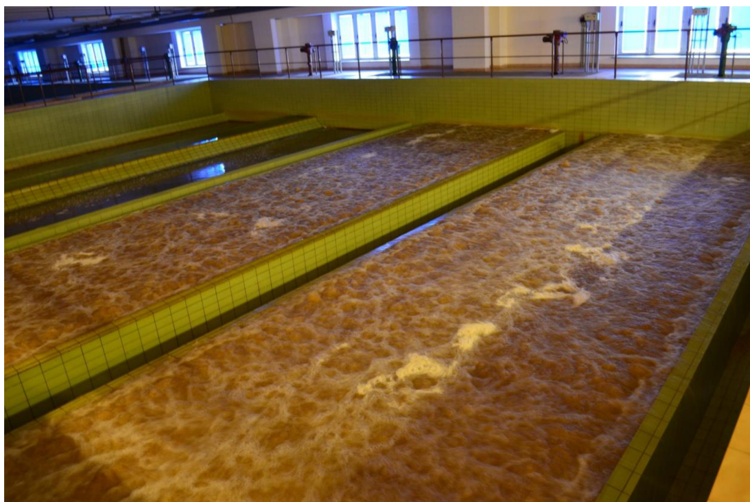
Obrázek 5: Pískový filtr na počátku praní (vpravo) a filtr v průběhu filtrace (vlevo) v ÚV Švařec
