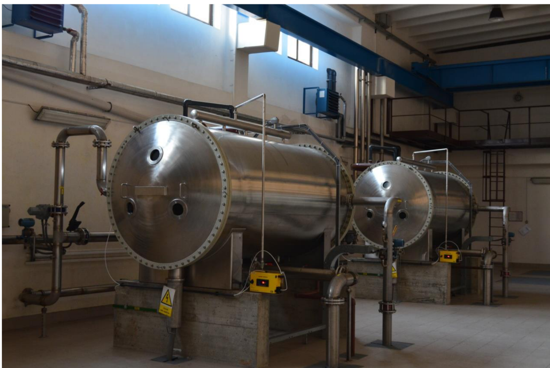
Obrázek 4: Generátory ozónu v budově ozonizace ÚV Švařec
