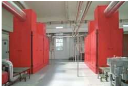
Obr. 2.11 Kogenerační jednotky v ČOV, výkon 2x 520 kW e palivo bioplyn a zemní plyn [7]
