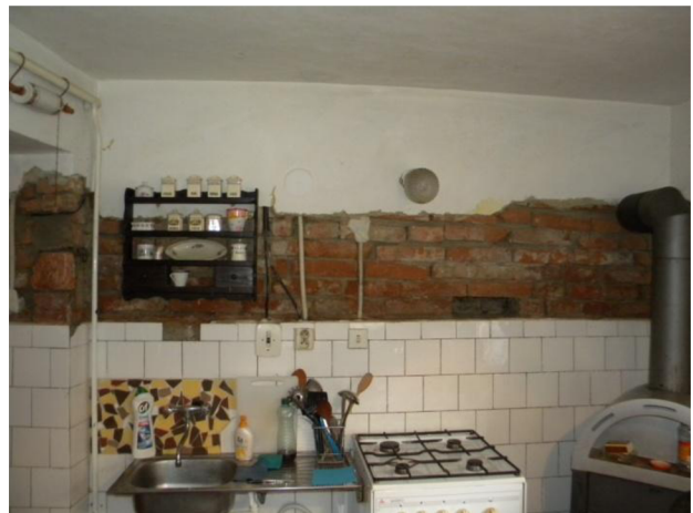
Obr. 11.2 obvodová zeď v kuchyni
