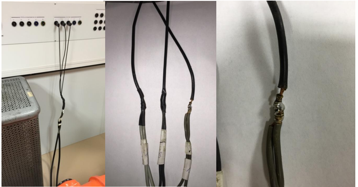
Obr. 18- Spojení vodičů pro stroje č.5 a č.6
