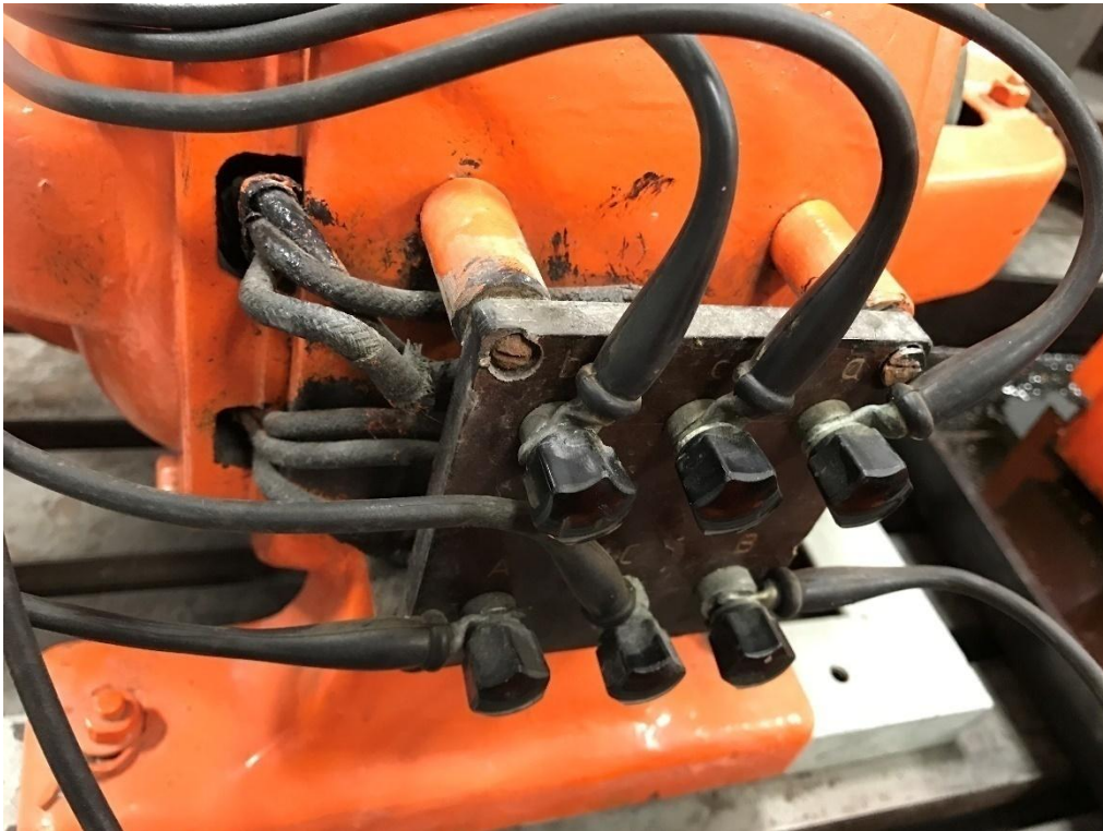
Obr. 22 - Svorkovnice třífázového asynchronního motoru
