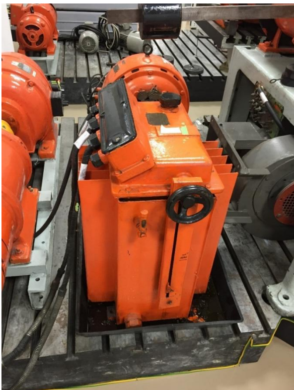
Obr. 17 - Regulační transformátor č.6
