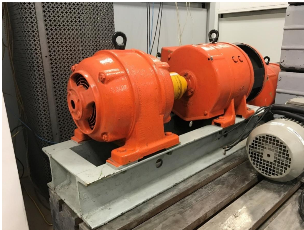
Obr. 34 - Asynchronní motor a dynamo na společné základně
