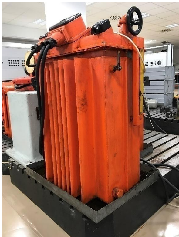
Obr. 27 - Regulační transformátor č.10
