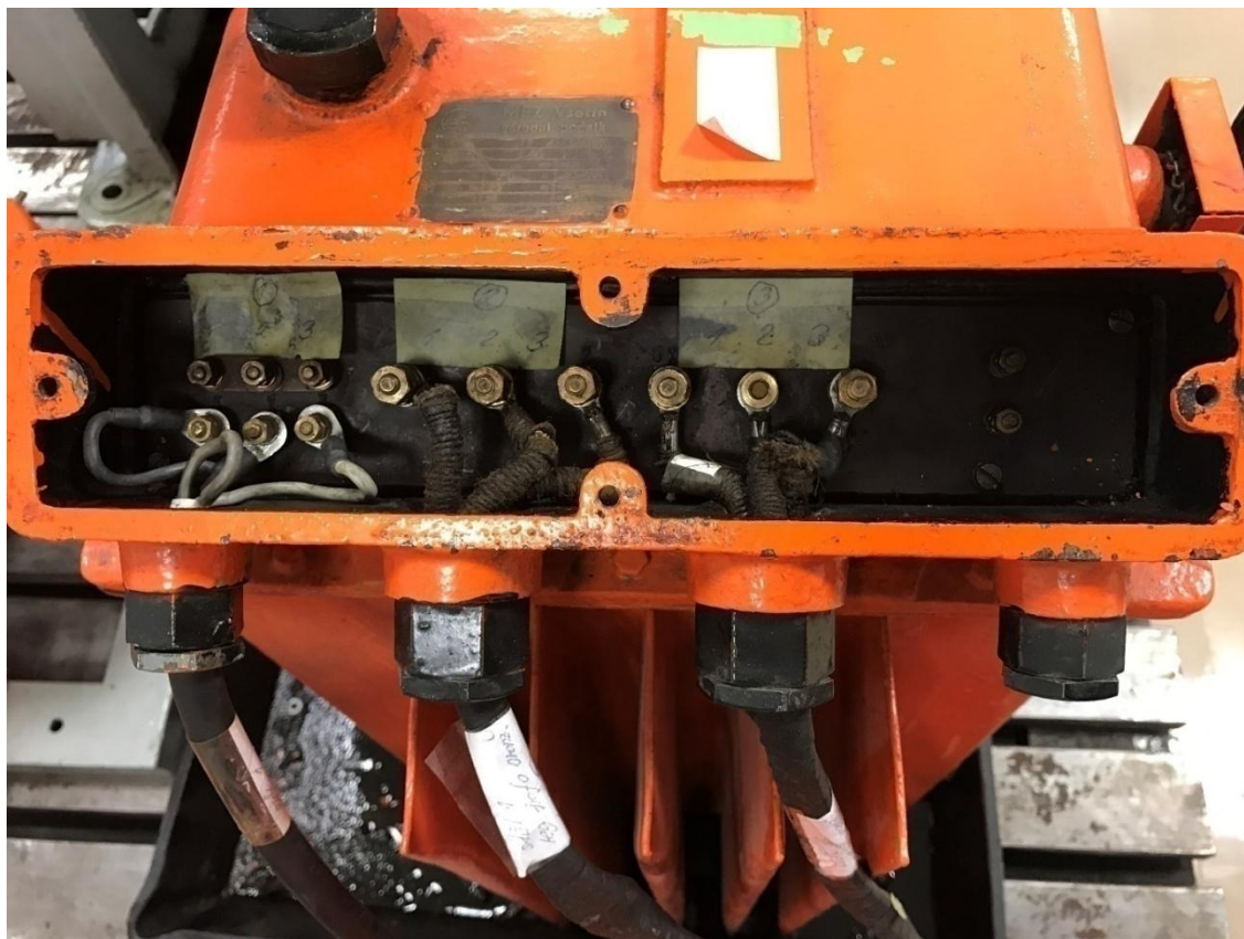
Obr. 19 - Svorkovnice regulačního transformátoru č.6
