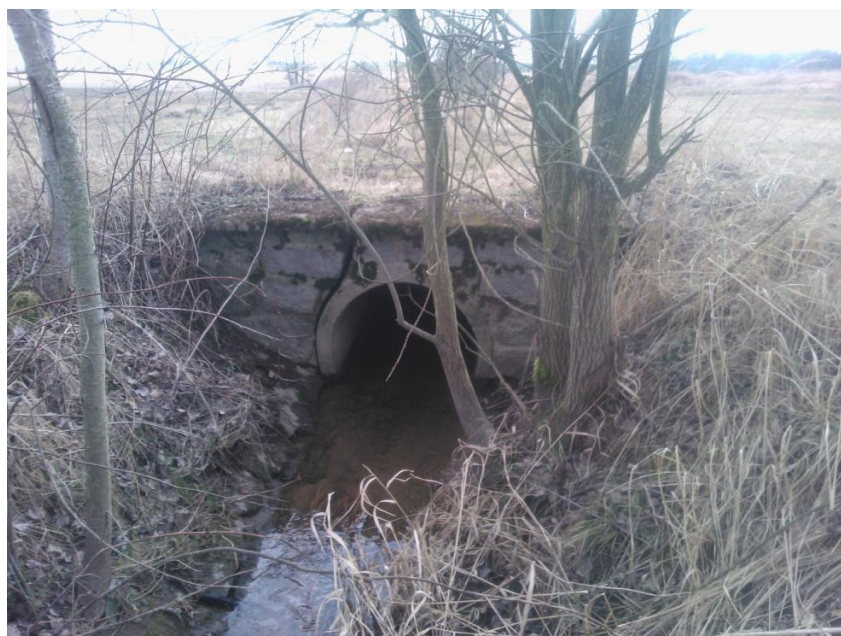
Obrázek 35: Detail poškození propustku na polní cestě u Vyhnanic
