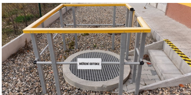
Obrázek 14: Parshallův žlab ČOV Louka u Litvínova (zdroj: autor práce).
