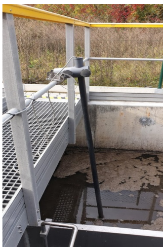
Obrázek 12: Nitrifikační nádrž s instalovanou kyslíkovou sondou ČOV Louka u Litvínova (zdroj: autor práce).
