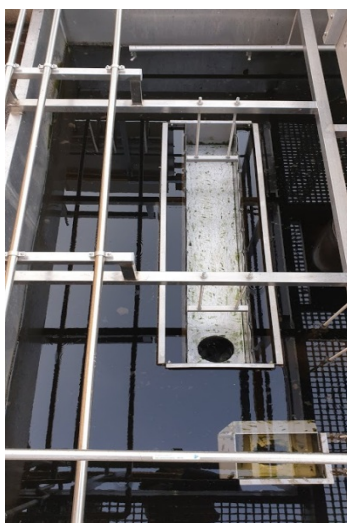
Obrázek 13: Dosazovací nádrž ČOV Louka u Litvínova (zdroj: autor práce).
