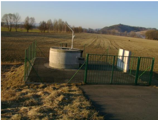
Foto 33 Přečerpávací stanice pro ČOV Leština u Lesnice (Drtilová, 4/2011)
