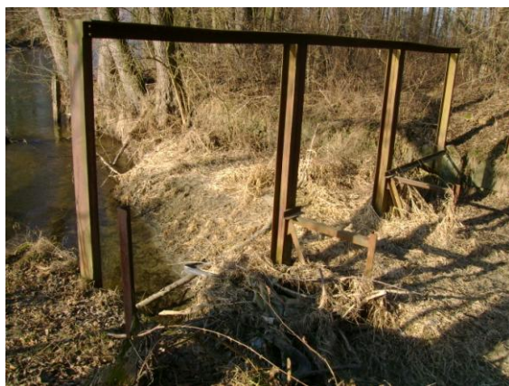
Foto 15 Ruina stavidla na Vitošovském náhonu (Drtilová, 3/2011)
