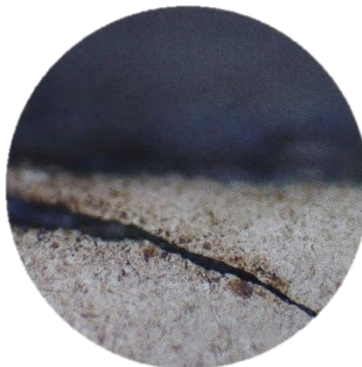
b) Transkrystalová koroze
