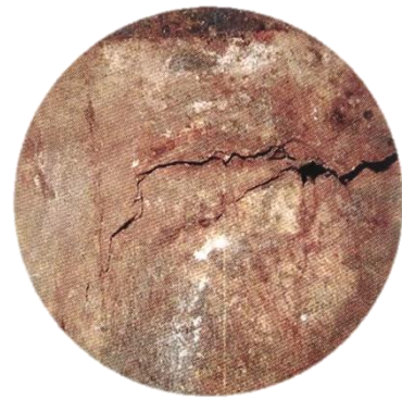
c) Korozní únava
