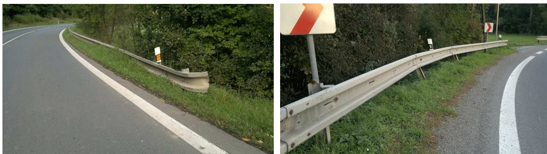
Obr. 49 Špatný náběh svodidla (zdroj: autor, 2014) Obr. 50 Poškozené svodidlo (zdroj: autor, 2014)
