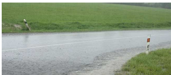
Obr. 56 Poškozené směrové sloupky (zdroj: autor, 2014)
