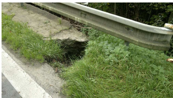
Obr. 59 Poškozená římsa (zdroj: autor, 2014)
