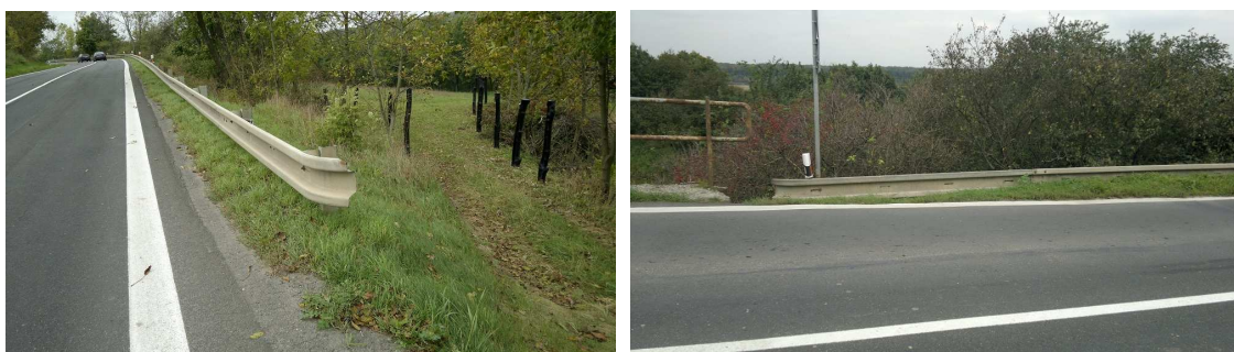
Obr. 67 Špatný náběh svodidla (zdroj: autor, 2014) Obr. 68 Svodidlo - most 635-015 (zdroj: autor, 2014)
