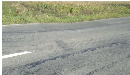
Obr. 11 Místní pokles (zdroj: autor, 2014)
