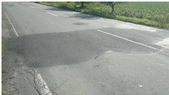
Obr. 7 Pokles vozovky (zdroj: autor, 2014)
