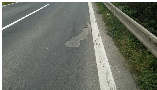
Obr. 57 Poškození vozovky (zdroj: autor, 2014)
