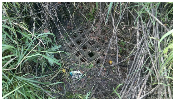
Obr. 13 Zanesená kanálová mříž (zdroj: autor, 2014)
