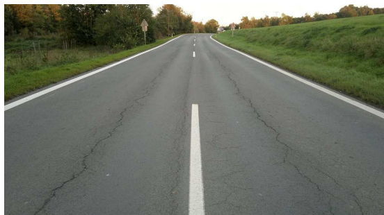
Obr. 51 Podélné trhliny (zdroj: autor, 2014)
