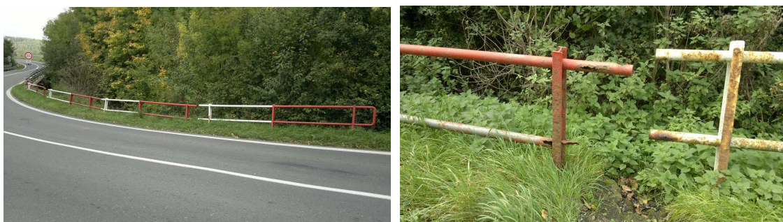
Obr. 65 Zábradlí - most 635-014 (zdroj: autor, 2014) Obr. 66 Stav zábradlí (zdroj: autor, 2014)
