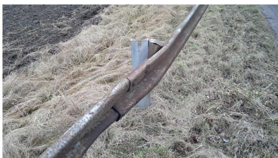
Obr. 20 Poškozené svodidlo (zdroj: autor, 2015)
