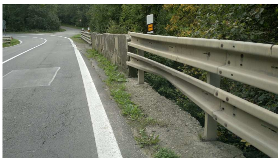
Obr. 58 Poškozené svodidlo (zdroj: autor, 2014)
