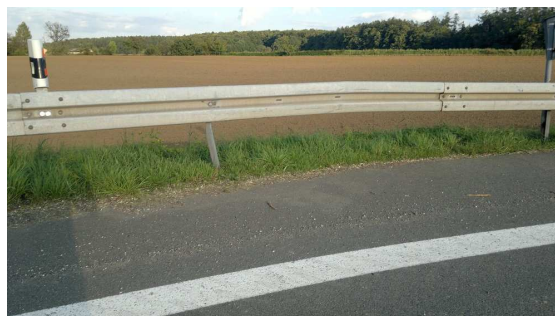
Obr. 38 Poškození svodidel (zdroj: autor, 2014)
