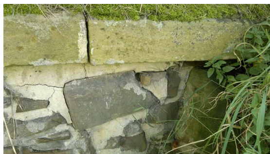
Obr. 15 Trhliny (zdroj: autor, 2014)
