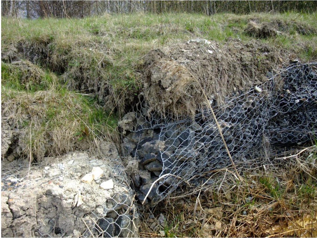
Foto 3 Eroze půdy v sektoru měření I. v místě 8. (Myslíková 2012)
