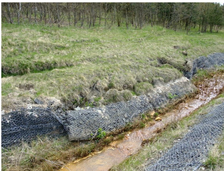
Obr. č. 18. Koryto toku v místě měření I. č. 8 se silnou erozí půdy (Myslíková, 2012)
