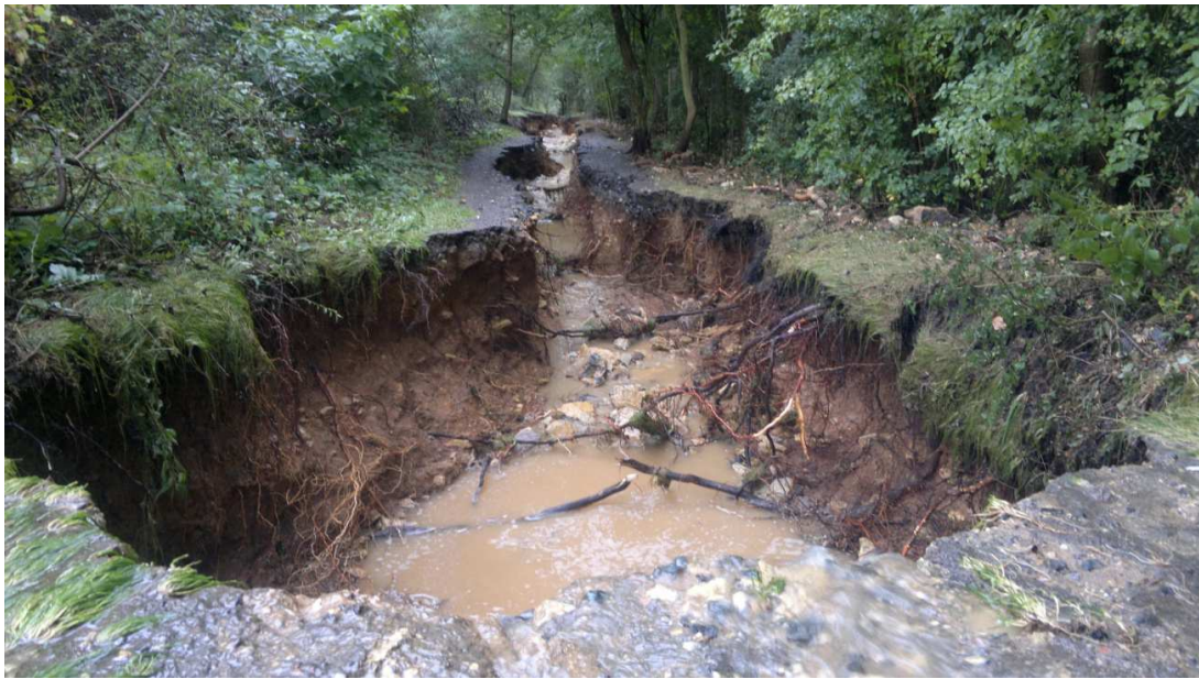
Obr. 11 – Povrchové znaky v blízkosti havárie 41
