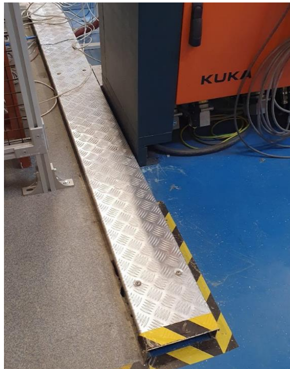
Obr. 13) Přebytný a nebezpečný kabelový žlab.
