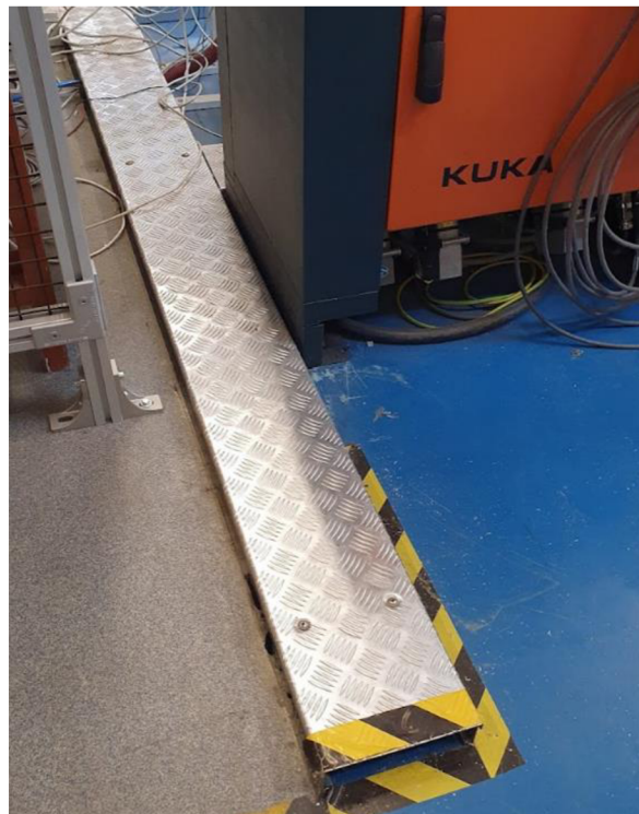
Obr. 13) Přebytný a nebezpečný kabelový žlab.
