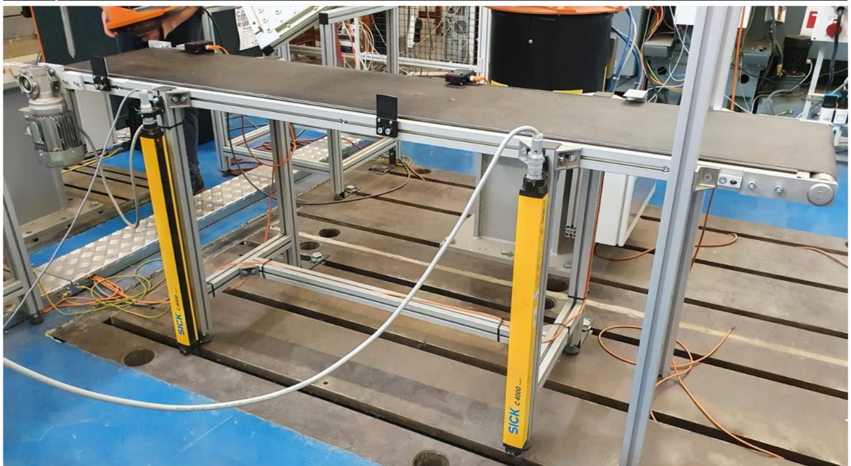
Pásový dopravník bez ochrany proti popálení a s nevhodně umístěnými optickými bránami.
