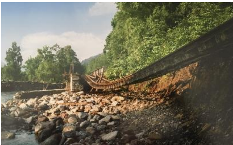
Obr. 3: Poničená železniční trať, Loučná nad Desnou, červenec 1997 (Marián Sopoliga 1997)
