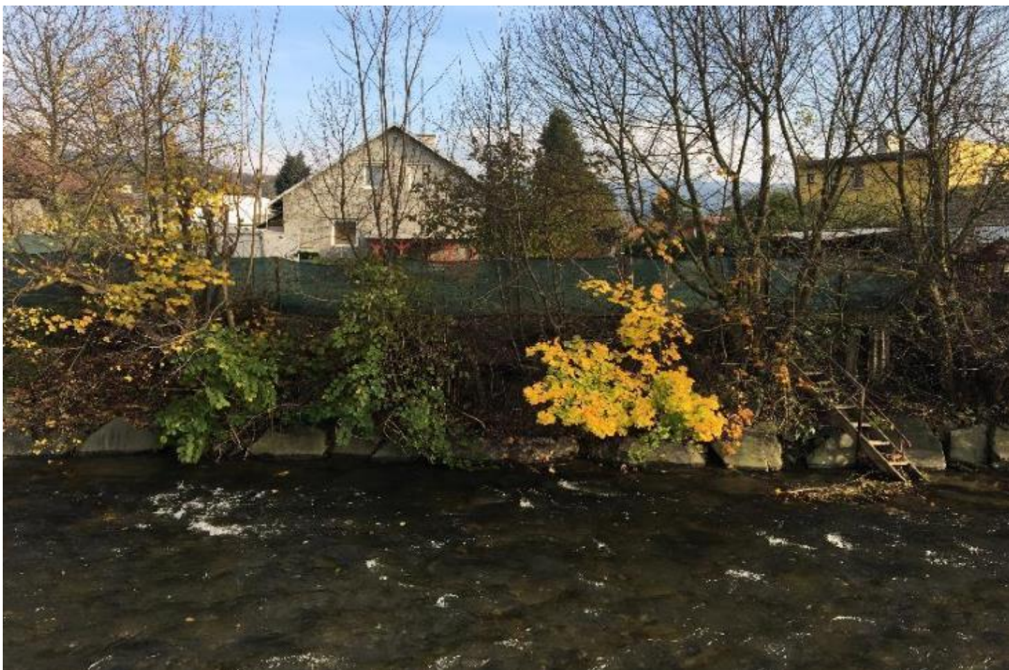
Příloha 14: Aktuální stav koryta řeky v zastavěném území obce Vikýřovice – Rapotín (Jílková 2018)
