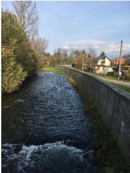
Obr.13: Ochranná protipovodňová zeď (Jílková 2018)
