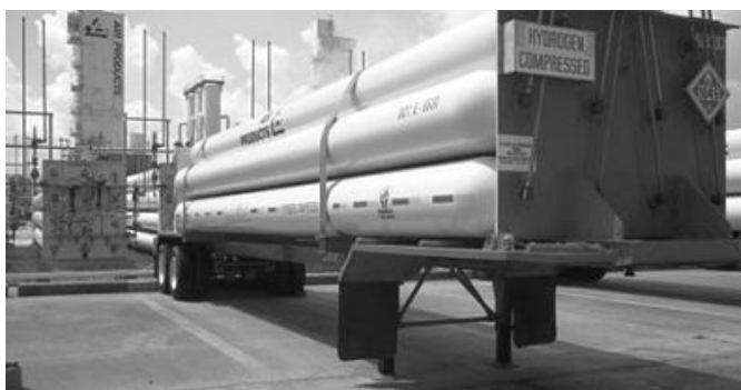
Obr.18:Nádrže na skladování plynného vodíku.[2]
