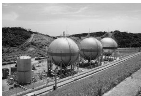
Obr.19:Nádrže na skladování kapalného vodíku.[2]
