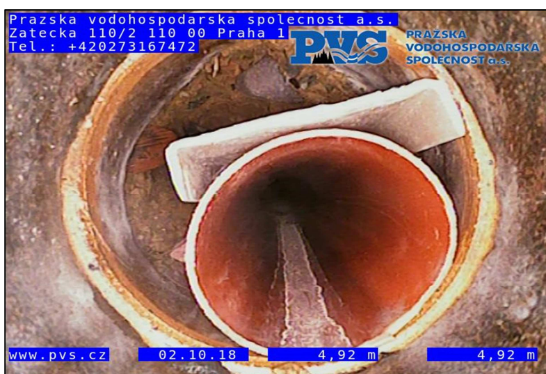
Obr. č. 37 - Změna profilu PVC DN 150 nevhodně (překážka v odtoku) – K5 třída poruchy 5
