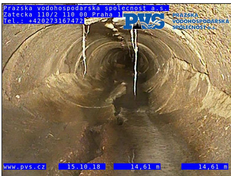
Obr. č. 40 - Deformace profilu, destrukce – K5 třída poruchy 5
