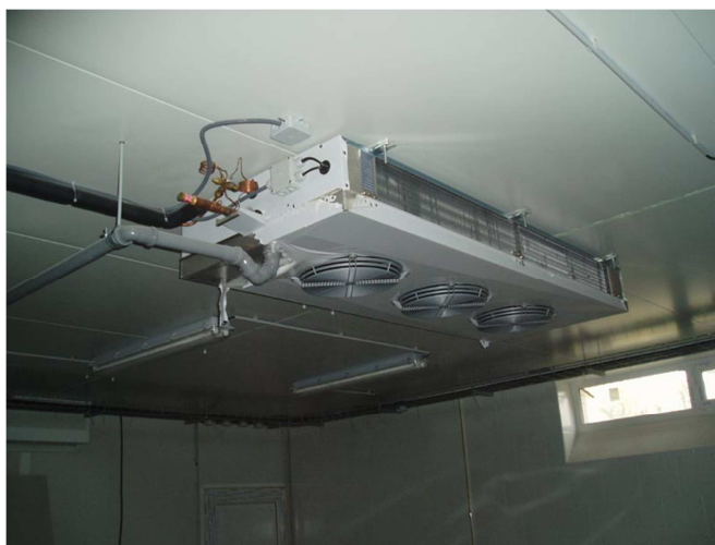
Obr. 61: Pohled na kondenzátní svod z výparníku
