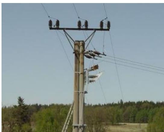
Obr. 5 Vzdušné vedení elektrické sítě [40]
