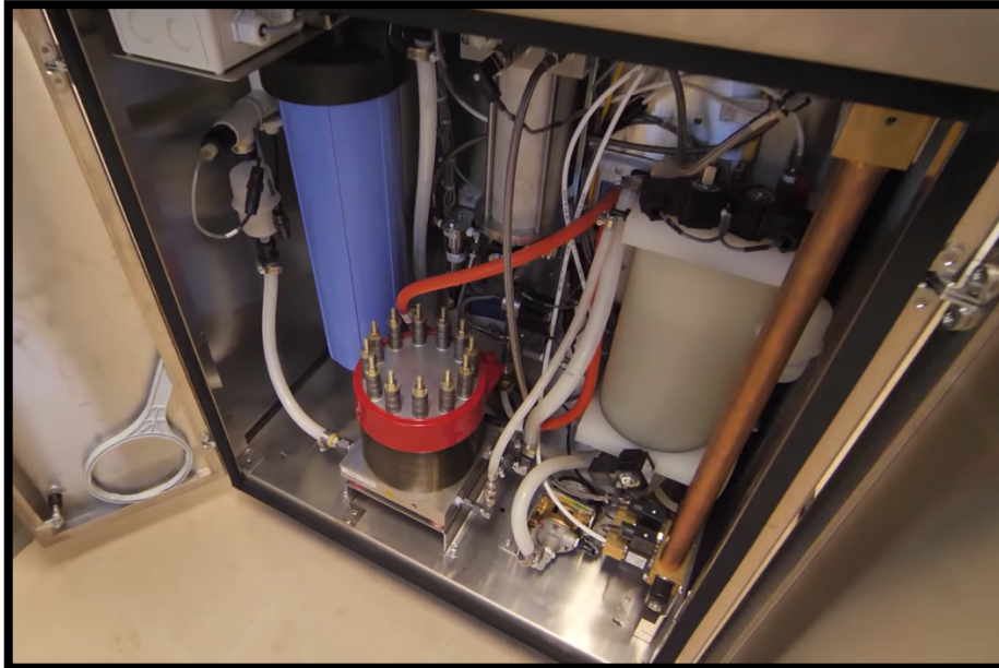
Obr. 5.3 Elektrolýzér s příkonem 7 kW, pripojený na fotovoltaickú elektrárň – príklad lokálnej výroby vodíka pomocou OZE (pilotný projekt výroby zeleného vodíka, firma ÚJV Řež, Česká republika). [41]
