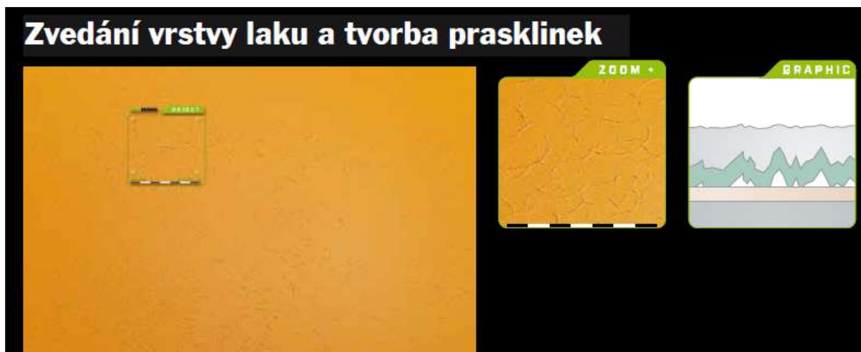
Obr. č. 21 - Zvedání vrstvy laku a tvorba prasklinek (Standothek, 2015)
