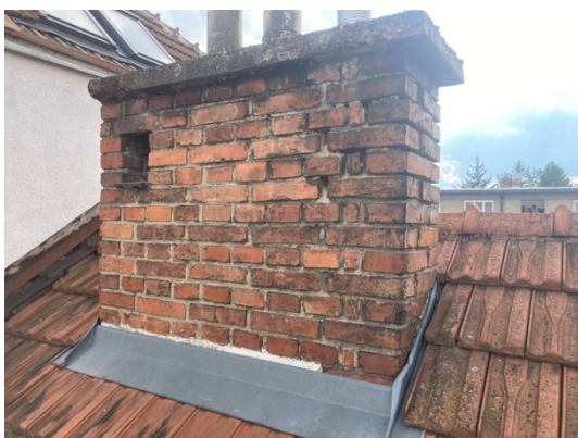
Obrázek 19 - Současný stav komínového pláště a komínové desky, zdroj: (vlastní)
