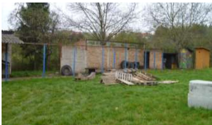
Obr. č. 52 - Zchátralá část budovy navazující na střelnici (stav k 10/2014); vlastní foto autora
