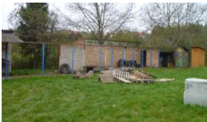
Obr. č. 52 - Zchátralá část budovy navazující na střelnici (stav k 10/2014); vlastní foto autora
