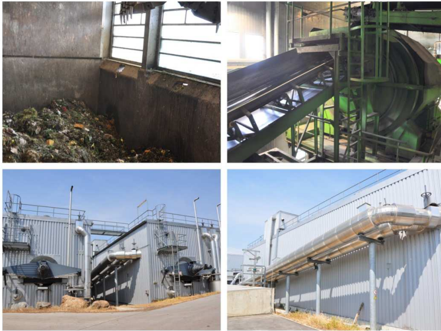
Obr. 7: Technologie KOMPOGAS - nevytríděný vstupní substrát (vlevo nahoře), třídící linka (vpravo nahoře), Horizontální fermentory s míchadly (vlevo a vpravo dole)
