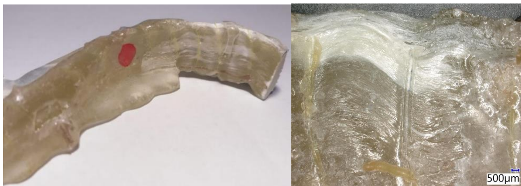
Obrázek 84 Zvlnění vláken na vnitřní straně ohybu třmínků uložených 1000 h v alkalickém roztoku při 20 °C (vpravo, 20x zvětšeno) a 40 °C (vlevo)
