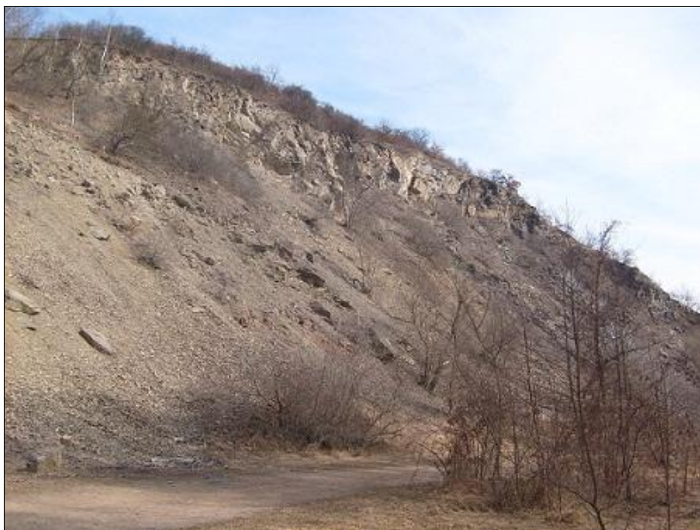
Foto č. 9 Lomová stěna u Tůmova mlýna
