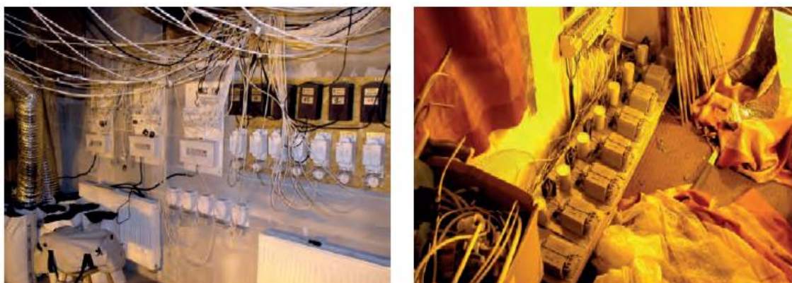
Obrázek č. 3 a 4: Elektroinstalace v nelegálních výrobnách drog.
