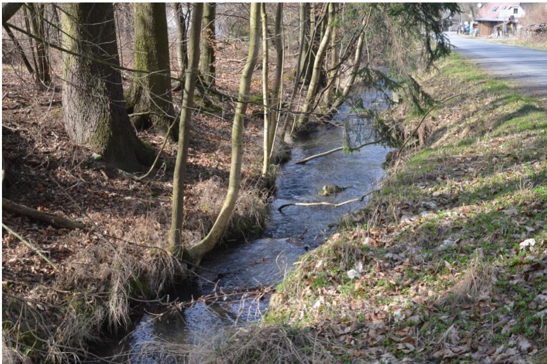
Obr. 25.: Erozí výrazně narušený levý břeh Blažovského potoka (Dominika Balatková, 2017)
