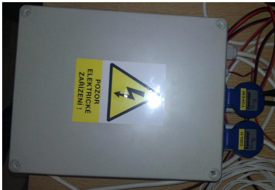
Obr. 14 Elektrikářská krabička pro regulaci teploty a regulaci rychlosti proudění vzduchu ve vytvořeném tunelu – pohled z hora
