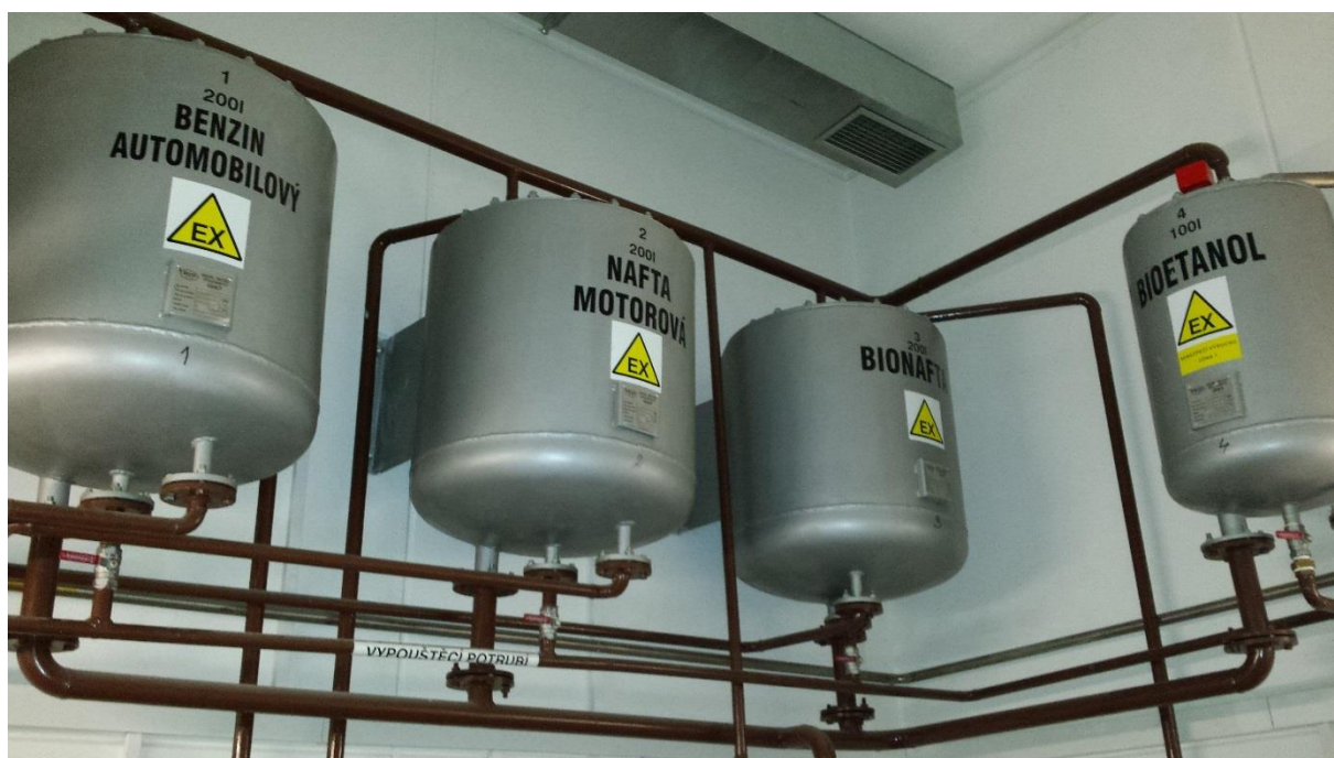
Obr. 10: Nádrže jednotlivých paliv v místnosti palivového hospodářství [vlastní]
