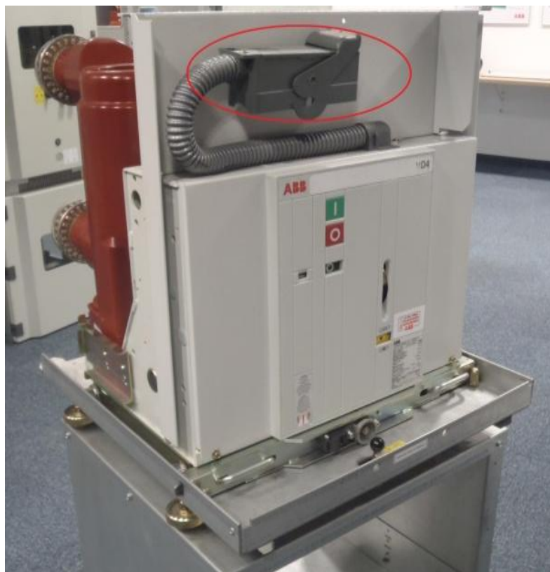
Obr. 23 Pohľad na vypínač ABB VD 4 z prednej strany, s vyznačenými možnými miestami vzniku čiastkových výbojov
