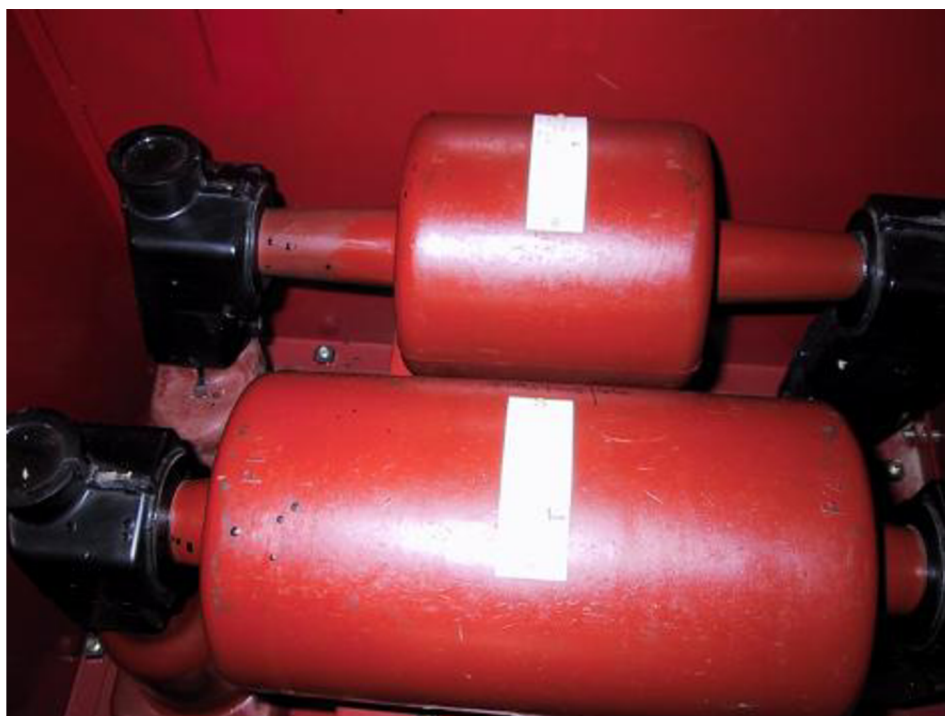
Obr. 8 Príklad poškodenia vnútornými čiastkovými výbojmi
