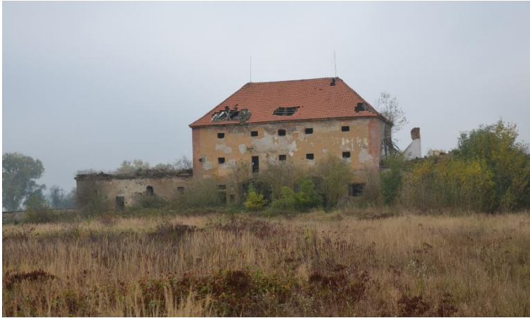
Obr. č. 4 – Statek v havarijním stavu
