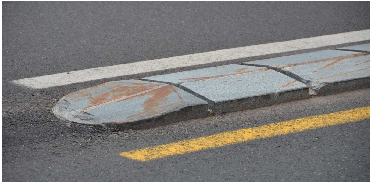
Obr. 49. Slovensko – Maribor – detail betonové tvarovky fyzického oddělení jízdních pruhů.
