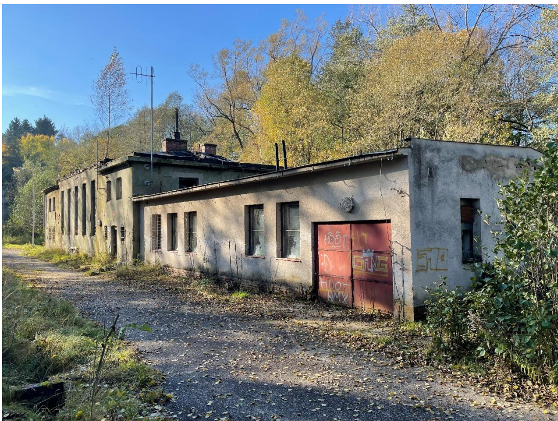
Příloha 14: Místní zdroj a úpravna vody v Machníně, současný stav (foto autor - 28. 10. 2021).
