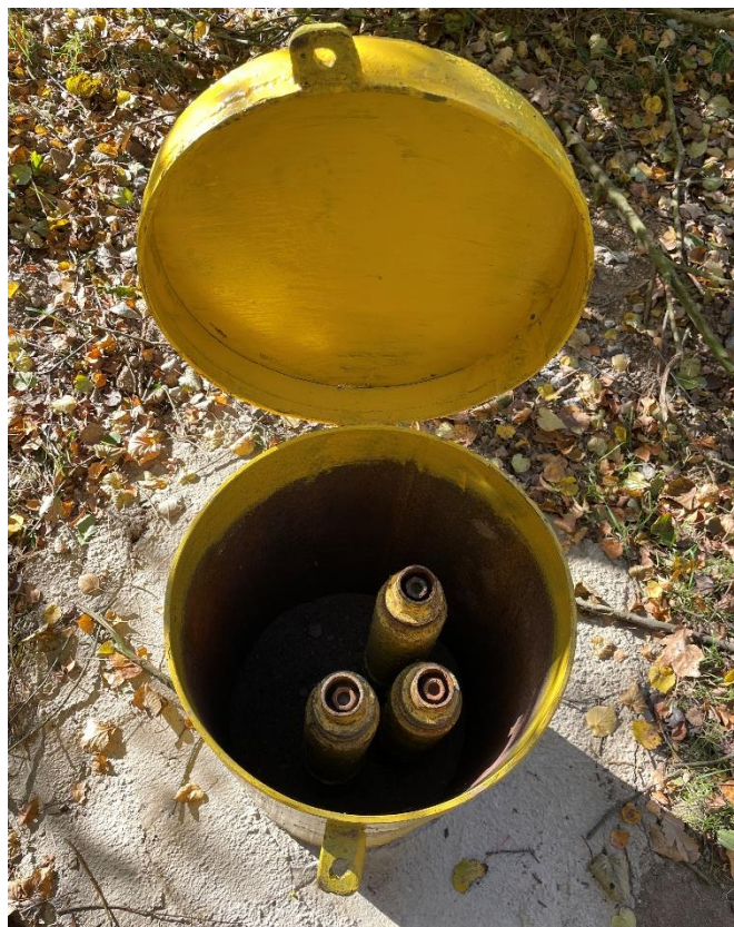
Příloha 7: Vnitřek ochranné schránky vrtu HPz 15/70/II na polském území, který monitoruje hladinu v kvartérním kolektoru (foto autor – 28. 10. 2021).
