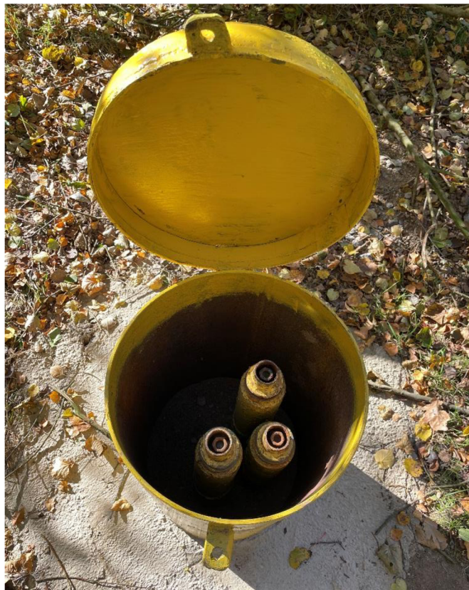
Příloha 7: Vnitřek ochranné schránky vrtu HPz 15/70/II na polském území, který monitoruje hladinu v kvartérním kolektoru (foto autor – 28. 10. 2021).
