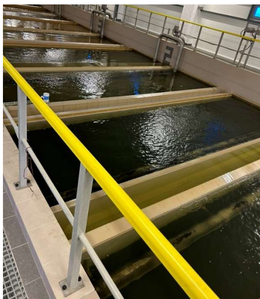
Obr. 5.4 Pískové filtry na úpravně vody [autor]
