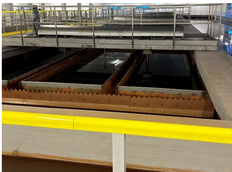
Obr. 5.2 Čířič na úpravně vody [autor]
