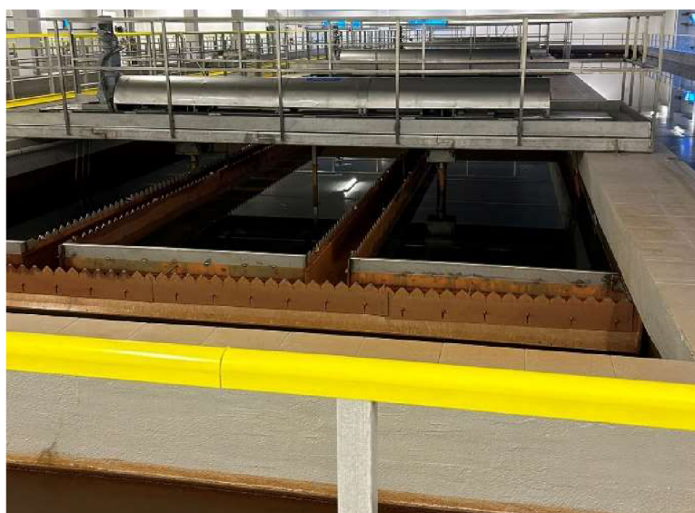
Obr. 5.2 Čířič na úpravně vody [autor]
