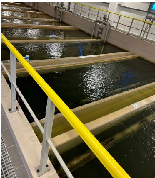
Obr. 5.4 Pískové filtry na úpravě vody [autor]
