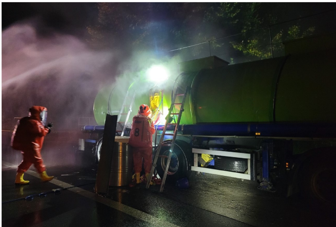
Obr. 2.2 Pohled na zajištění trhliny pláště cisterny za současného zkrápění par
