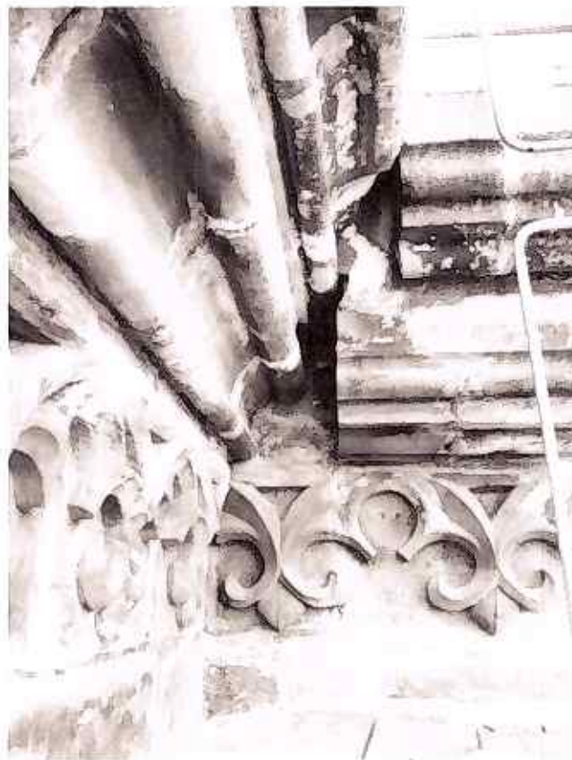
14. Praha, kostel Panny Marie před Týnem, dolní ochoz západního průčelí, dodatečné připojení římsy jižní věže k římsě jihozápadního opěráku hlavní lodi. Foto: aut.
